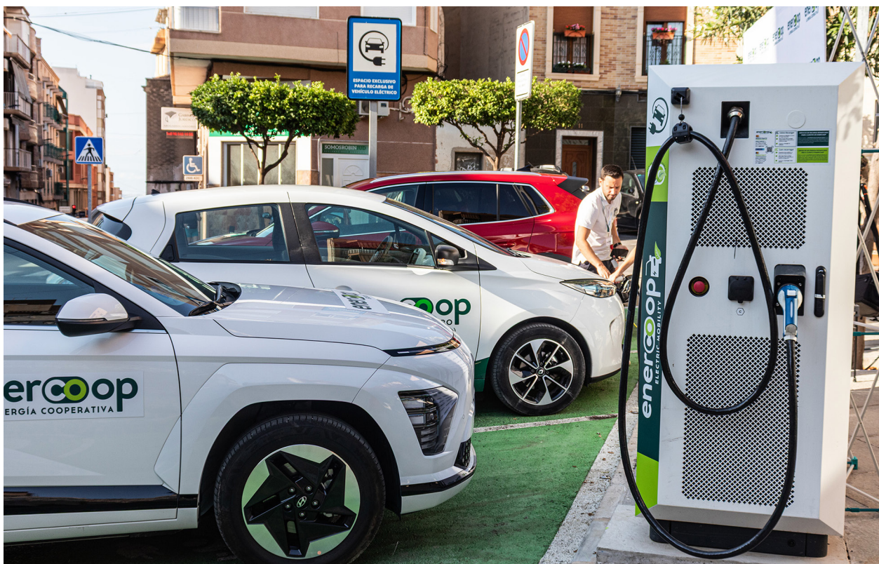
Carregador súper ràpid d'ús públic a Crevillent.
